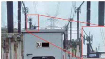
Fig.5 Roteador R1 posicionado no pátio de 525kV
