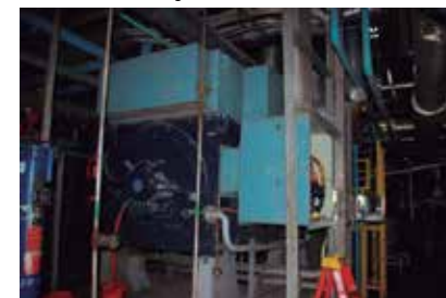
Fig.11 Motor de bomba de alimentação de caldeira, 4kV, 694A (FL), 5400hp
