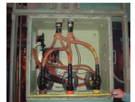
Fig.12 Motor Terminal Box antes da instalação do MSIM
