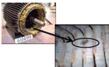
Fig.18 local da falha do motor entre as fases b e c
